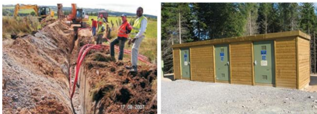
Figure 19 : Déroulage et pose des câbles (à gauche), poste de livraison (à droite)
